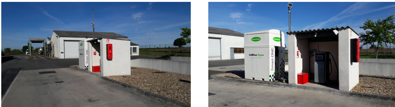
FIGURE 14 : STATION SERVICE ET STOCKAGE D'ADBLUE
